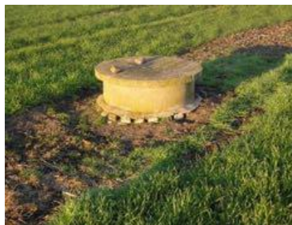
Fig. 107 – Esempio di pozzo correttamente coperto.
